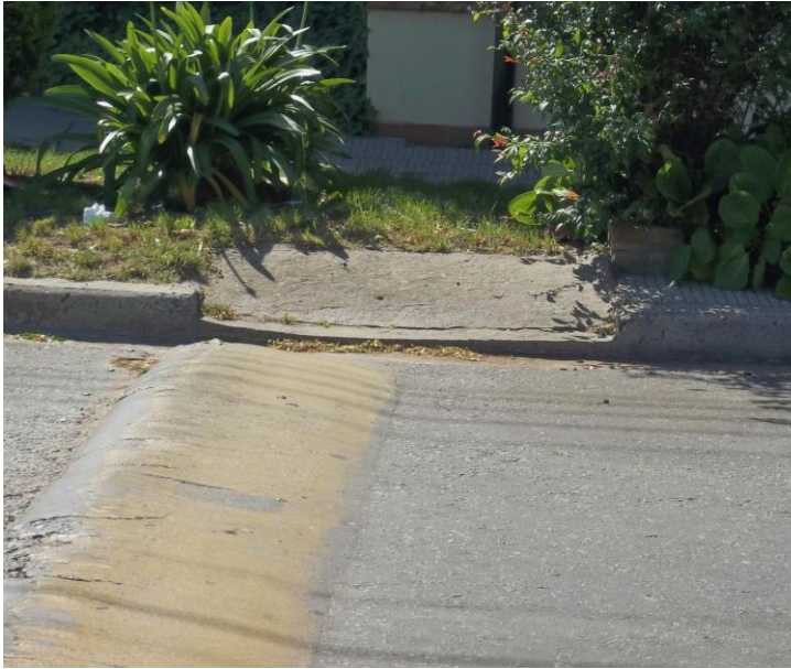
Foto 9. Badén reductor de velocidad obstaculizando el descenso y/o ascenso a la rampa.
