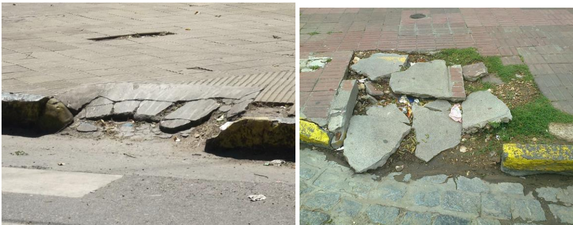
Foto 8. Rampas en malas condiciones de mantenimiento y/o inutilizables.
